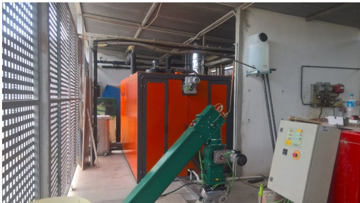
Εικόνα 16. Θέρμανση πισίνας στο Calpe (Spain) με υπολείμματα κλαδεμάτων. Μοντέλο λέβητα: RHK AK300 από τη Heizomat.
